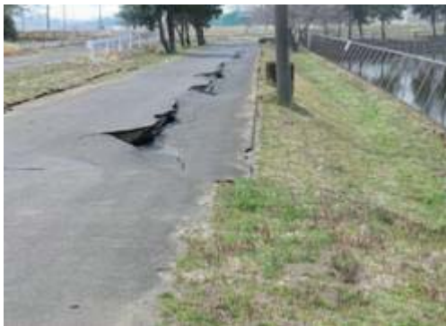
図 4.2 ため池堤体のすべり・陥没
