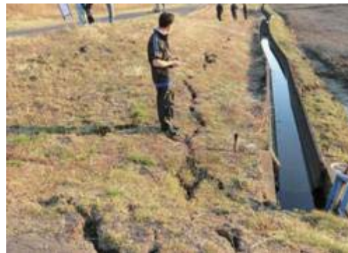
図 4.3 盛土部すべりにともなう水路被害
